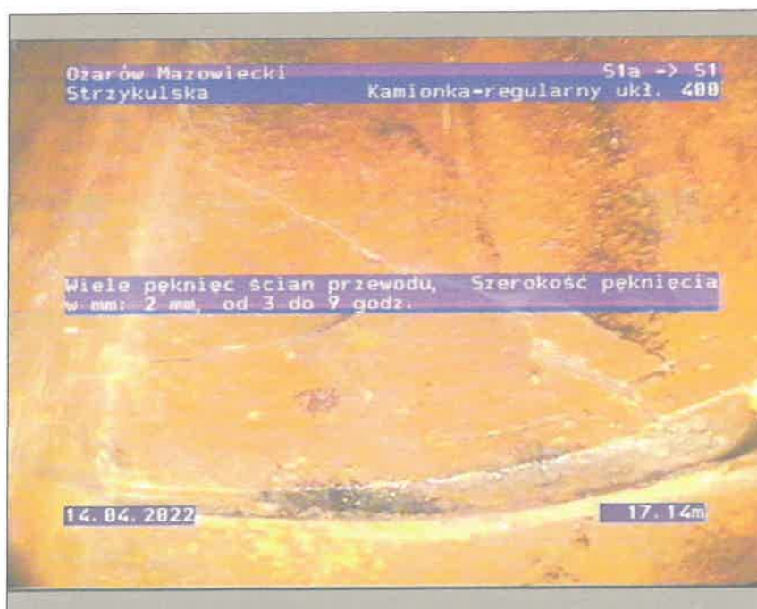
Zdjęcie: 12_1_3_14042022_131714_A.JPG 17,14m, Wiele pęknięć ścian przewodu, Szerokość pęknięcia w mm: 2 mm, od 3 do 9 godz.
