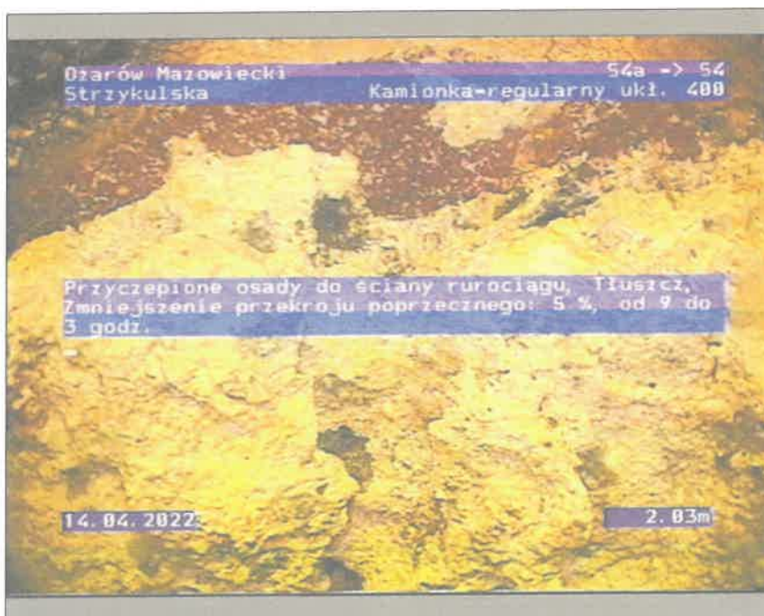
Zdjęcie: 7_1_3_14042022_124257_A.JPG 2,03m, Przyczepione osady do ściany rurociągu, Tłuszcz, Zmniejszenie przekroju poprzecznego: 5 %, od 9 do 3 godz.
