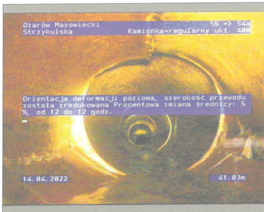
Zdjęcie: 6_1_12_14042022_124030_A.JPG 41,03m, Orientacja deformacji pozioma, szerokość przewodu została zredukowana Procentowa zmiana średnicy: 5 %, od 12 do 12 godz.
