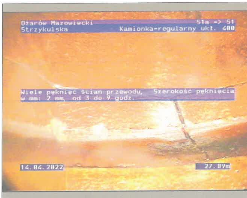
Zdjęcie: 12_1_6_14042022_132120_A.JPG 27,89m, Wiele pęknięć ścian przewodu, Szerokość pęknięcia w mm: 2 mm, od 3 do 9 godz.
