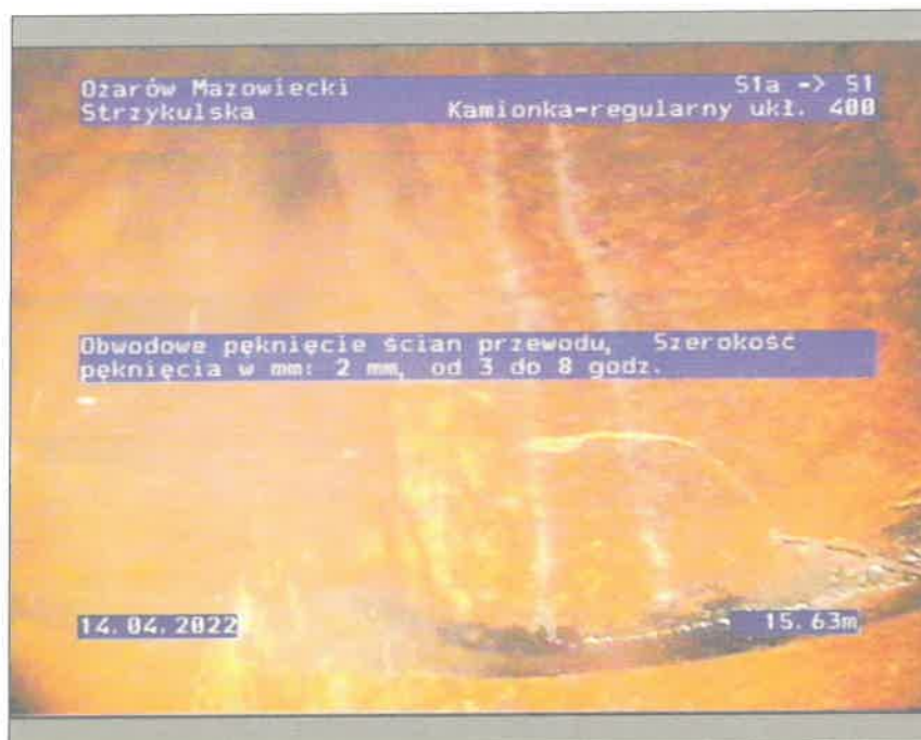
Zdjęcie: 12_1_2_14042022_131650_A.JPG 15,63m, Obwodowe pęknięcie ścian przewodu, Szerokość pęknięcia w mm: 2 mm, od 3 do 8 godz.
