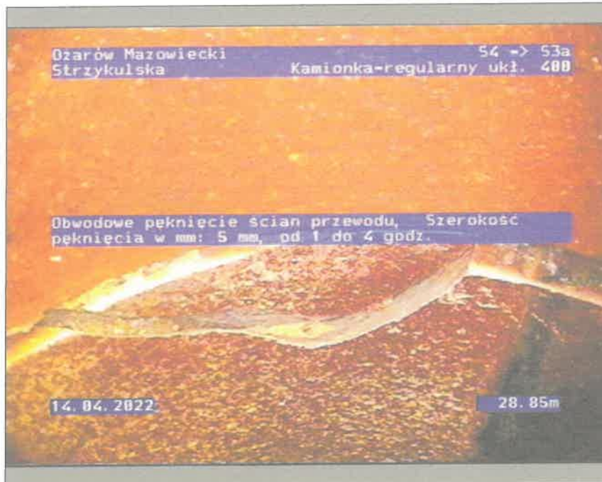
Zdjęcie: 8_1_2_14042022_125638_A.JPG 28,85m, Obwodowe pęknięcie ścian przewodu, Szerokość pęknięcia w mm: 5 mm, od 1 do 4 godz.
