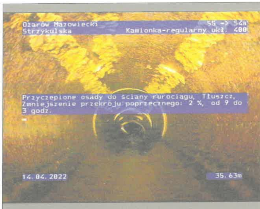
Zdjęcie: 6_1_10_14042022_123913_A.JPG 35,63m, Przyczepione osady do ściany rurociągu, Tłuszcz, Zmniejszenie przekroju poprzecznego: 2 %, od 9 do 3 godz.
