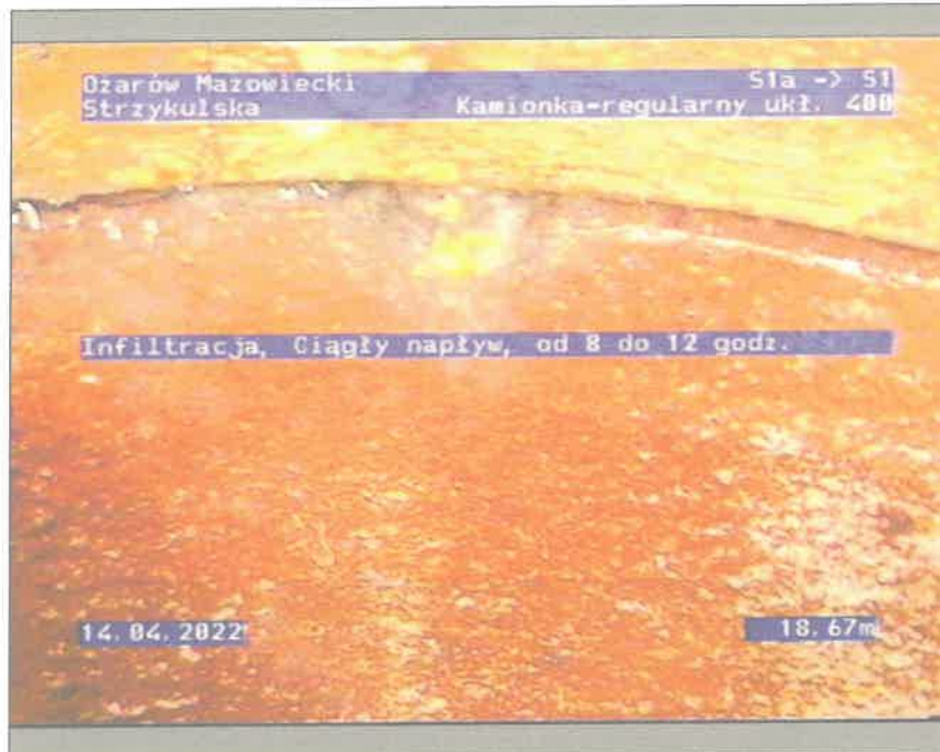
Zdjęcie: 12_1_4_14042022_131751_A.JPG 18,67m, Infiltracja, Ciągły napływ, od 8 do 12 godz.
