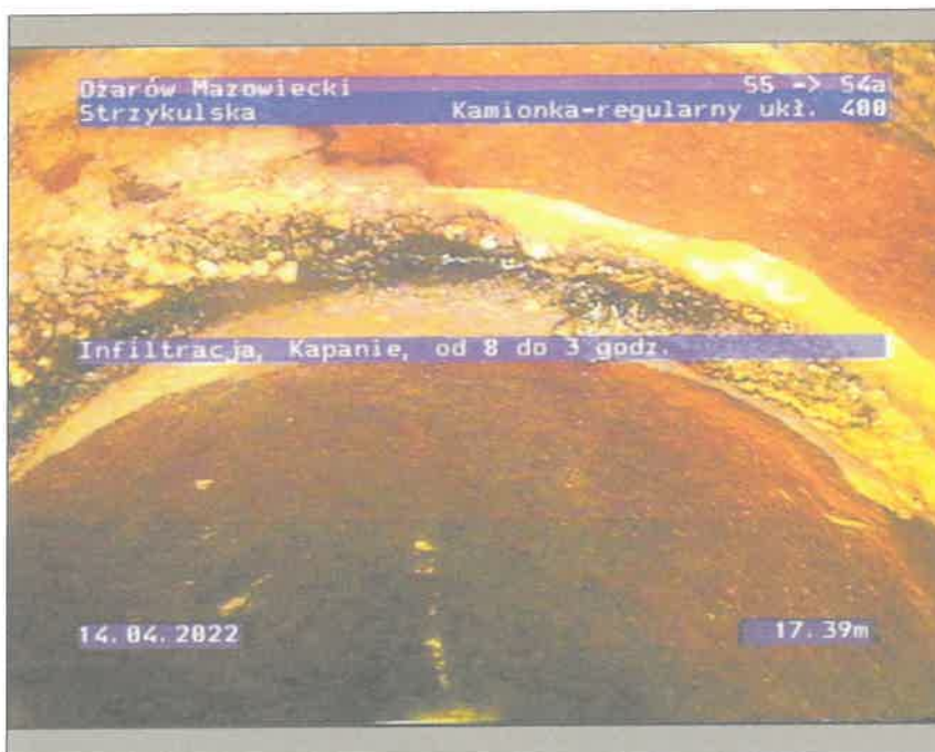
Zdjęcie: 6_1_5_14042022_123215_A.JPG 17,39m, Infiltracja, Kapanie, od 8 do 3 godz.
