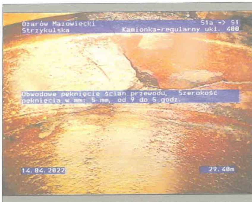
Zdjęcie: 12_1_7_14042022_132154_A.JPG 29,4m, Obwodowe pęknięcie ścian przewodu, Szerokość pęknięcia w mm: 5 mm, od 9 do 5 godz.
