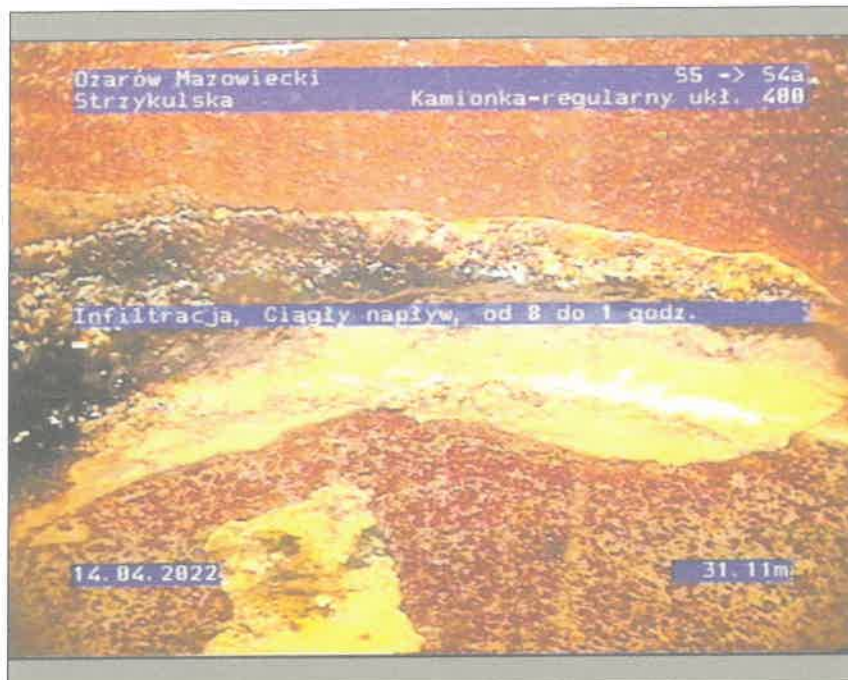
Zdjęcie: 6_1_8_14042022_123819_A.JPG 31,11m, Infiltracja, Ciągły napływ, od 8 do 1 godz.
