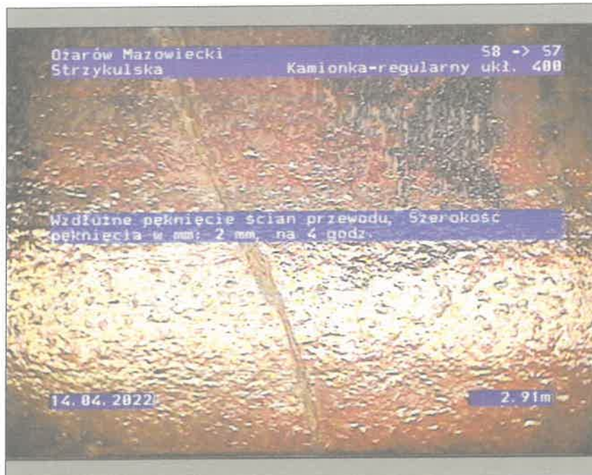
Zdjęcie: 1_1_2_14042022_094430_A.JPG 2,91m, Wzdłużne pęknięcie ścian przewodu, Szerokość pęknięcia w mm: 2 mm, na 4 godz.
