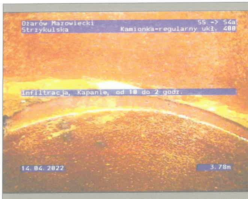
Zdjęcie: 6_1_2_14042022_123006_A.JPG 3,78m, Infiltracja, Kapanie, od 10 do 2 godz.
