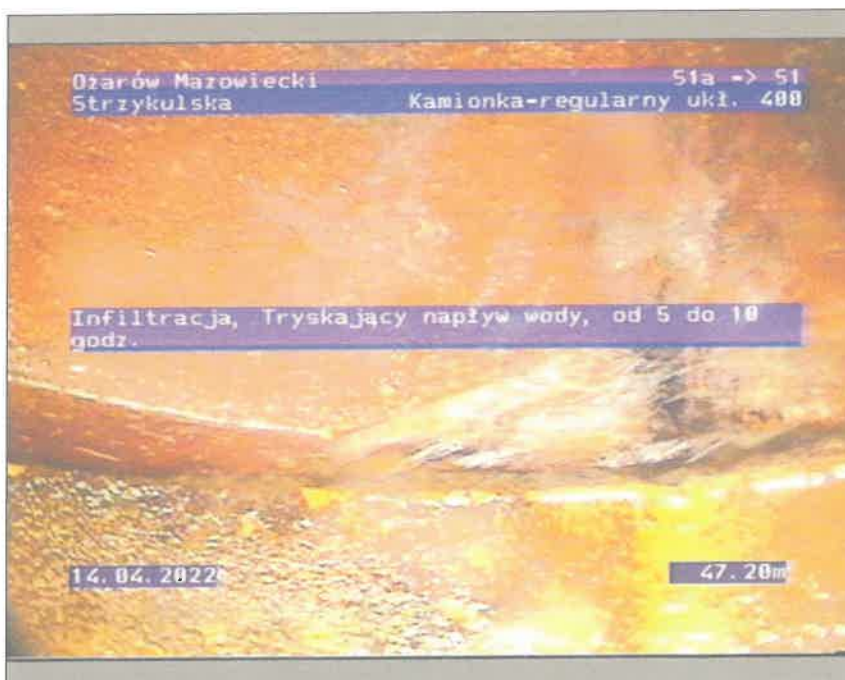
Zdjęcie: 12_1_8_14042022_132343_A.JPG 47,2m, Infiltracja, Tryskający napływ wody, od 5 do 10 godz.
