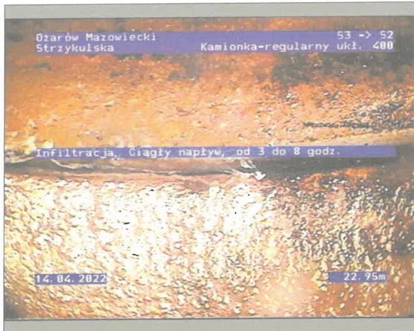
Zdjęcie: 10_1_4_14042022_130815_A.JPG 22,95m, Infiltracja, Ciągły napływ, od 3 do 8 godz.
