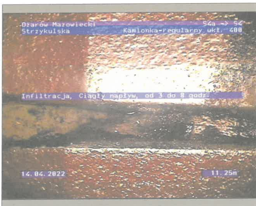
Zdjęcie: 7_1_5_14042022_124446_A.JPG 11,25m, Infiltracja, Ciągły napływ, od 3 do 8 godz.
