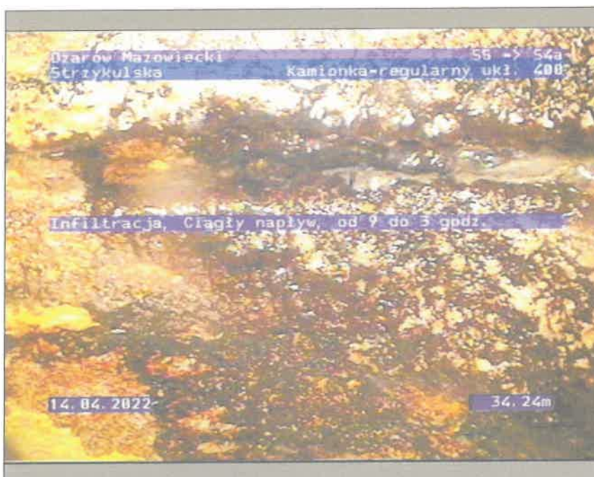
Zdjęcie: 6_1_9_14042022_123850_A.JPG 34,24m, Infiltracja, Ciągły napływ, od 9 do 3 godz.
