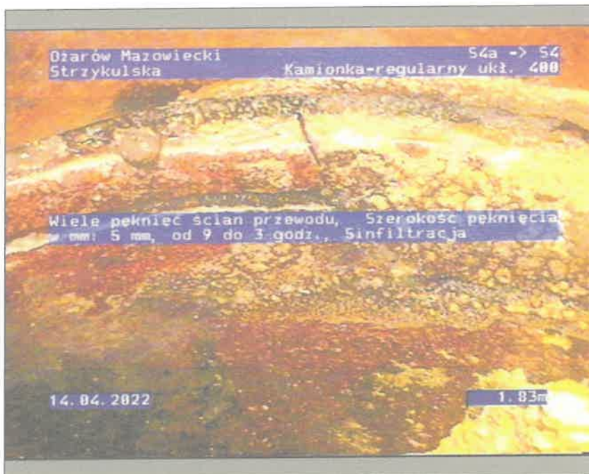
Zdjęcie: 7_1_2_14042022_124238_A.JPG 1,83m, Wiele pęknięć ścian przewodu, Szerokość pęknięcia w mm: 5 mm, od 9 do 3 godz.
